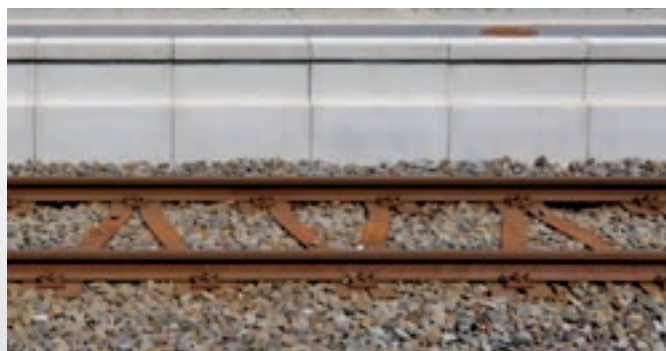
Bahnsteigkante am Gleis mit Y-Schwellen
